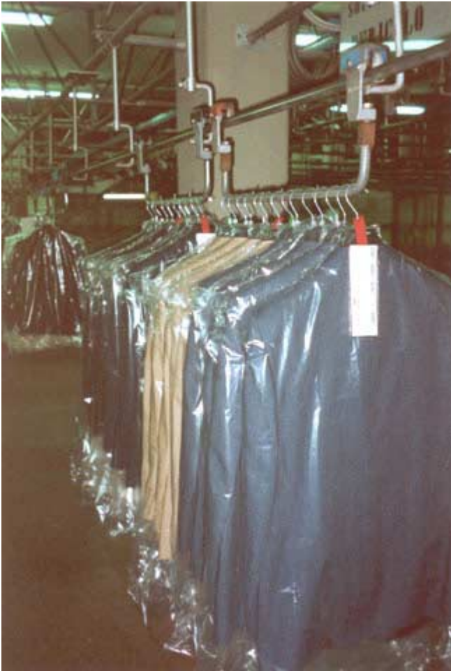
Fig. n. 8: particolare dell'impianto per la movimentazione dei capi su monorotaia.
