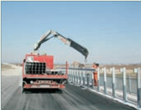
Situazione non regolare, i lavoratori sono privi di casco e il gancio dell'autogrù è privo di sistema antisganciamento
