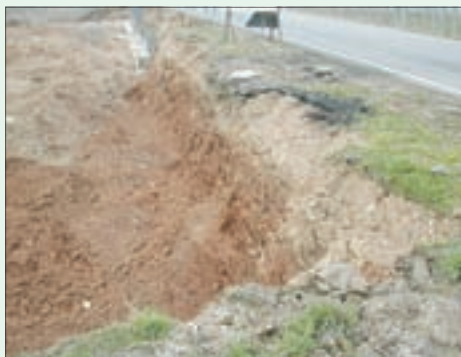
Situazione non regolare, il fronte dello scavo non è inclinato e può franare; non ci sono segregazioni dell'area alla base e sul ciglio dello scavo
