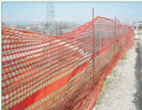
Situazione non regolare, la rete non è sufficiente per proteggere dalla caduta dal ciglio dello scavo
