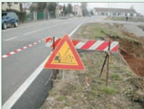
Situazione regolare, il ciglio della strada è pulito ed è presente idonea segnaletica
